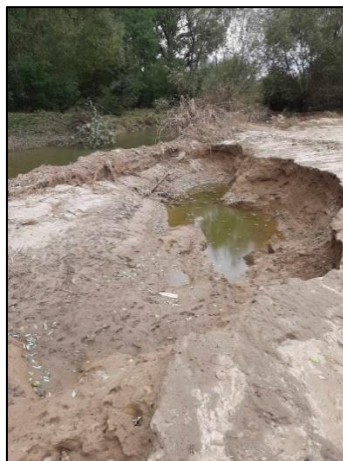
Rys. 4-2.4 Fotografia przedstawiająca szkody powstałe w wyniku powodzi z września 2024 r.
