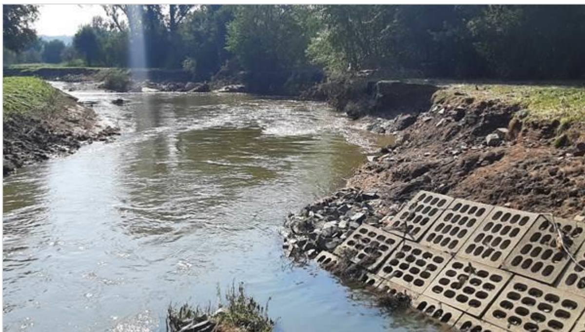
Rys. 2-11. Miejscowość Prudnik rz. Prudnik w km 16+470 - wyrwa na prawym brzegu powodująca wymycie drogi gminnej biegnącej wzdłuż skarpy rzeki.
