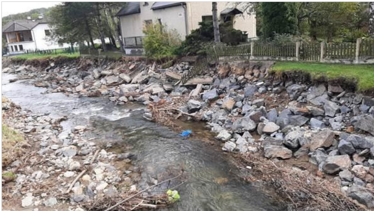
Rys. 2-10. Miejscowość Jarnołów, rz. Złoty Potok w km 13+630 - wyrwa na prawym brzegu zagrażająca stabilności budynku jednorodzinnego.
